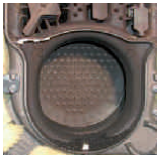
Brennkammer eines Kessels mit Ökoheizöl schwefelarm
