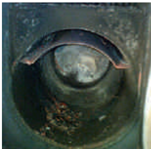
Brennkammer eines Kessels mit Ablagerungen durch die Verbrennung von Heizöl Euroqualität
